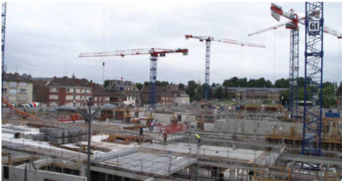
Beauvais. Les parkings sont terminés. Les ouvriers réalisent les rez-de-chaussée des futures boutiques. (L.P./C.)
